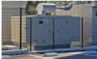
非常用発電機
