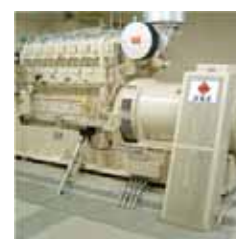
非常用発電システム
