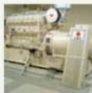
非常用発電システム
