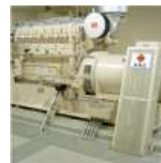
非常用発電システム
