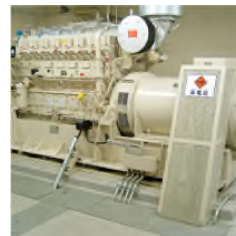
非常用発電システム
